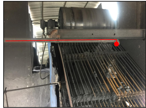
筛分环节洒水设施
