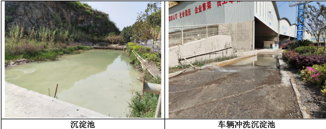
图 2-6 现有废水处理设施
