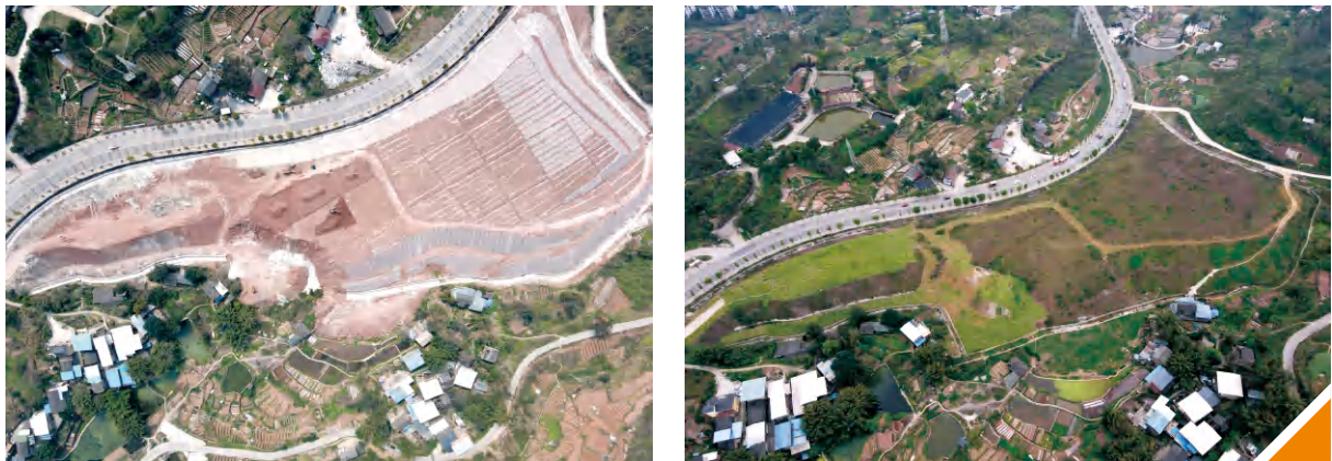
图2.4 渝武高速公路弃渣场（左图为整改中，右图为整改后）
